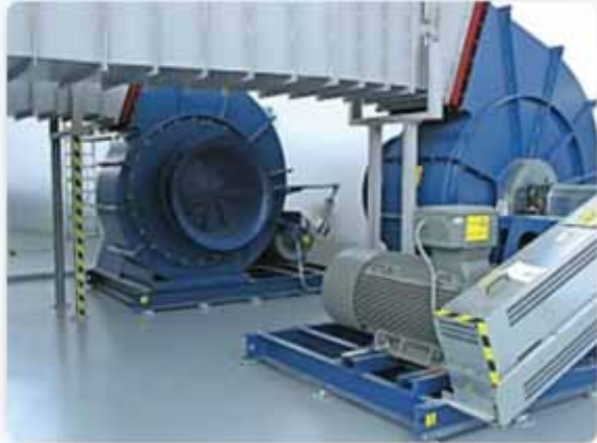
El desequilibrio es crítico en las instalaciones de ventiladores (acoplamiento directo o con transmisión por pulea de correa)
